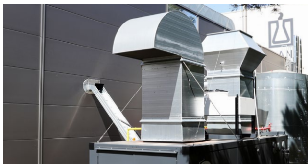
Blockheizkraftwerk bei BRAND KG
